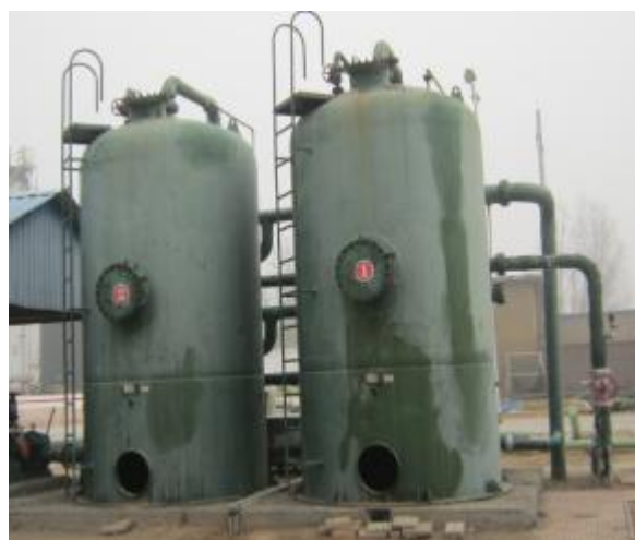
金刚砂过滤器
